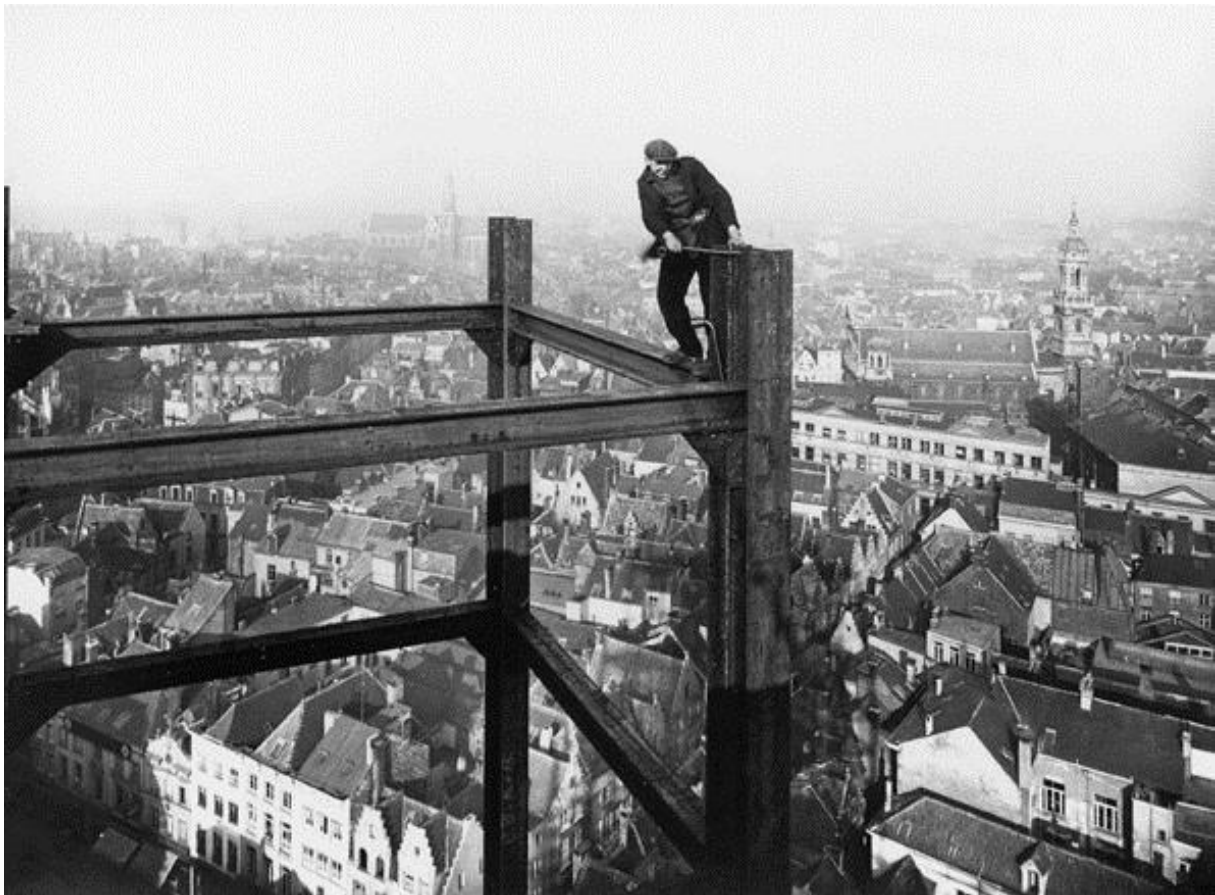
Vakmannen werken aan het staalskelet van de Boerentoren © Architectuurarchief van de provincie Antwerpen
